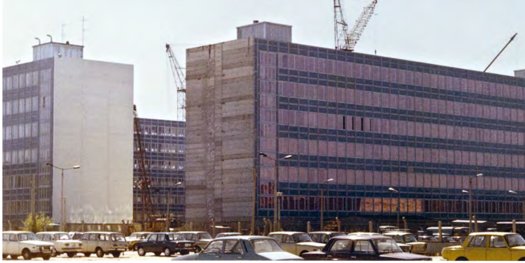
↑ Abb. 168: Haus 40 bis 42 kurz vor der Fertigstellung (von der Gotlindestraße aus gesehen). In Haus 40 (hinterer Block in der Bildmitte) saß die Hauptabteilung VII, zuständig für die Volkspolizei und das Ministerium des Innern. Diese Zuständigkeit war geprägt durch eine intensive Zusammenarbeit mit der Volkspolizei, bei der das MfS der dominierende Partner war, und durch eine ebenso intensive Überwachung des anderen Sicherheitsorgans durch die Staatssicherheit.
