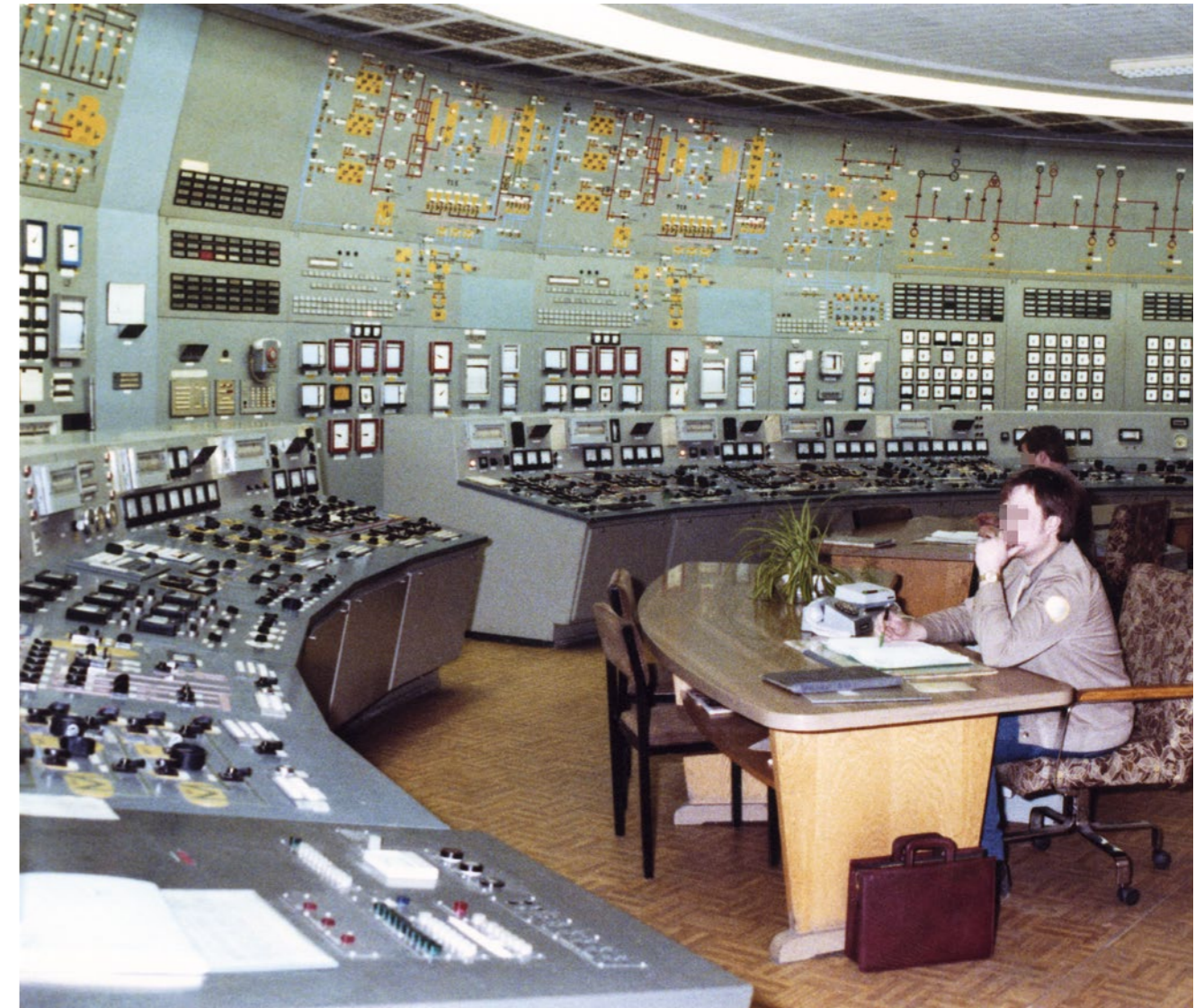
> Von der Blockwarte wurde der Kraftwerksbetrieb überwacht und gesteuert. 1988 BArch, MfS, HA XXII, Fo, Nr. 217, Bild 11
